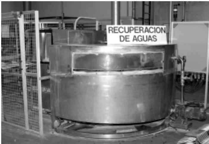
10 – Desde fuera, la parte del carrusel de las máscaras, en la zona en la que se recuperan las aguas de lavado
