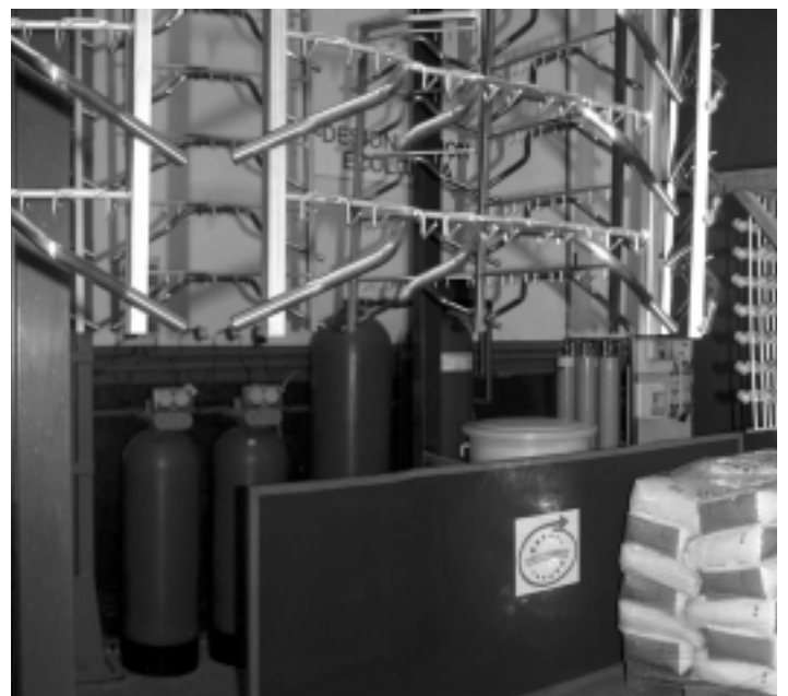
6 – La instalación de desmineralización mediante resinas de intercambio iónico
