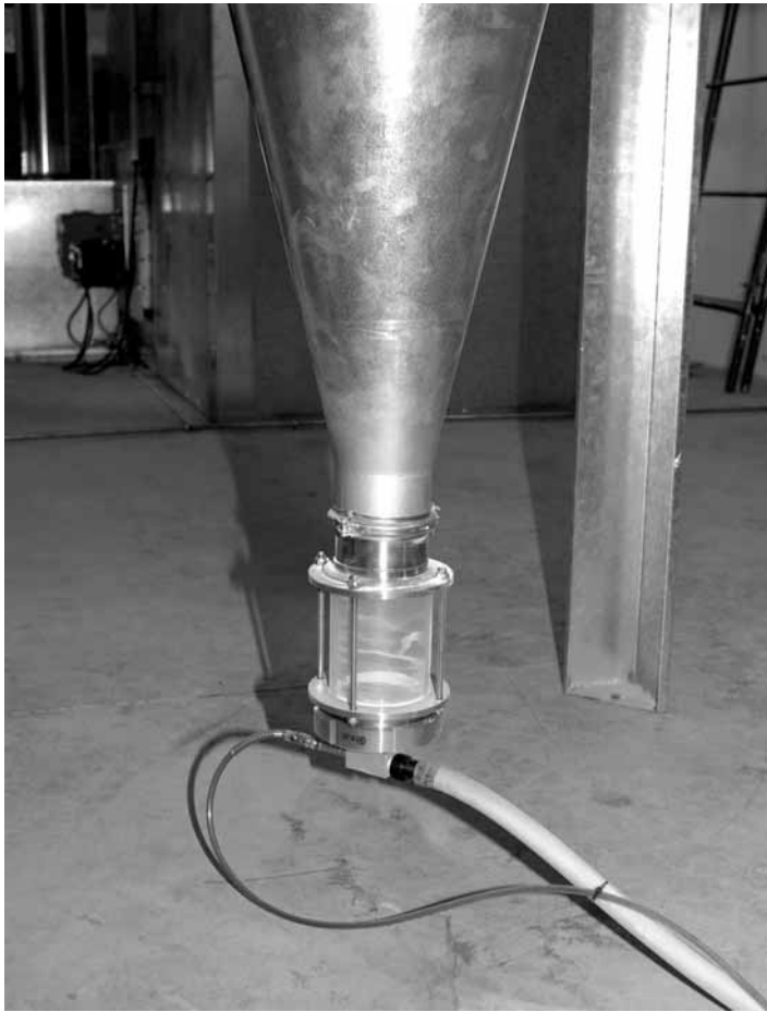
10 – Un detalle del fondo del ciclón, que permite el control visual de la correcta operatividad del sistema de recuperación del polvo.
