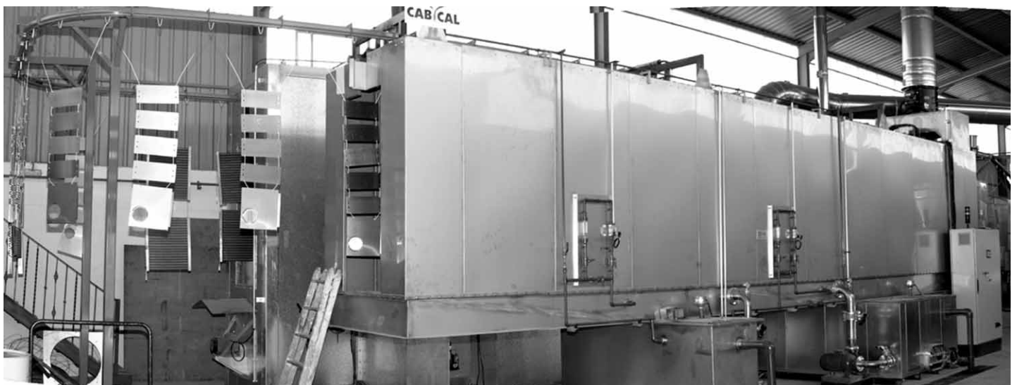
5 – El túnel de pretratamiento.
