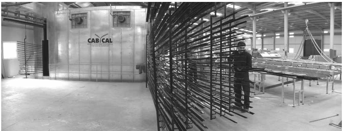
20 - El horno desde la zona de enfriamiento y descarga, de acumulación transversal.
