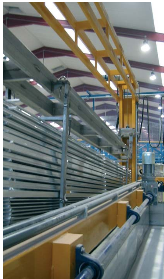
puente grúa automático para pretratamiento
