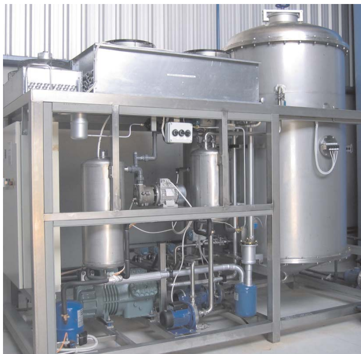
Evaporador a vacío con bomba de calor
