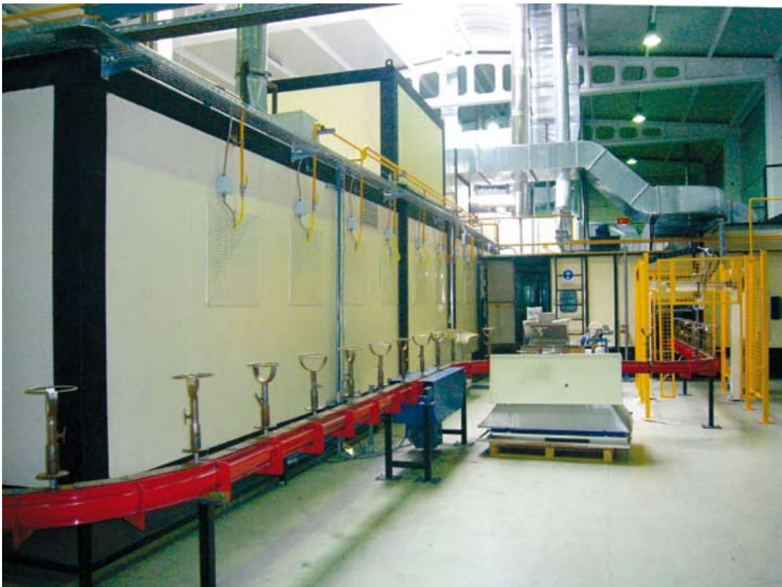
1 – La línea de pintura para piezas de plástico de Farplas, reformada por Cabycal.
