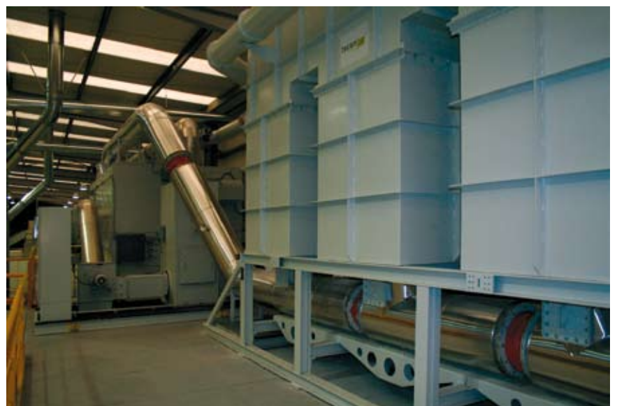
12 – Em primeiro plano, o oxidador térmico regenerativo (RTO) de 3 torres.
