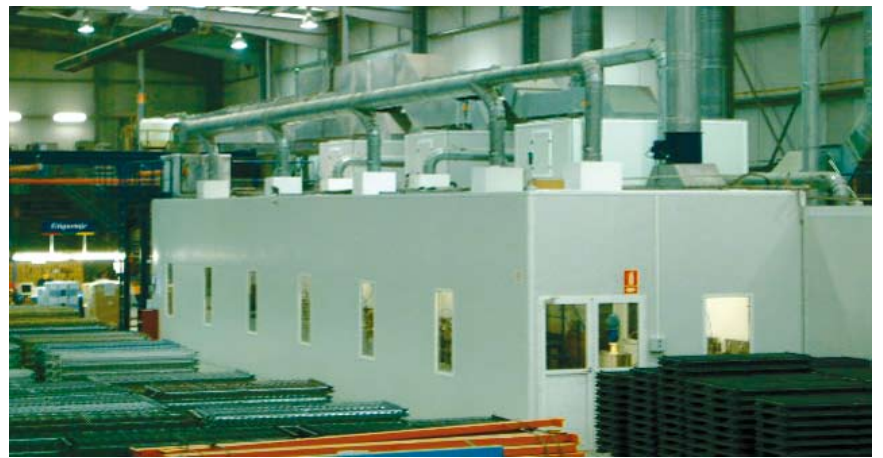
7 – La zona de las cabinas. Tras cada cabine hay una zona de pre-evaporación y secado con IR de onda media.
