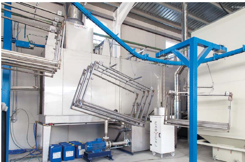
El túnel de pretratamiento.
